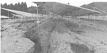
大雨で地盤が削られた太陽光パネル（2016年5月、鹿児島県霧島市、中村満雄さん提供）
