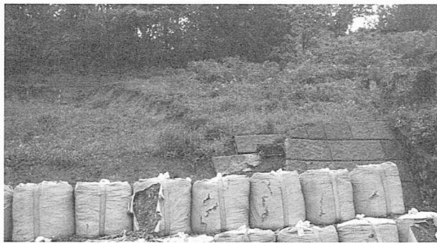
4ページ写真の太陽光パネル設置場所に隣接した山の裾野。頂上付近の土を削ったことで、バランスが崩れて裾野に土砂崩れが起きた（埼玉県秩父郡横瀬町）
