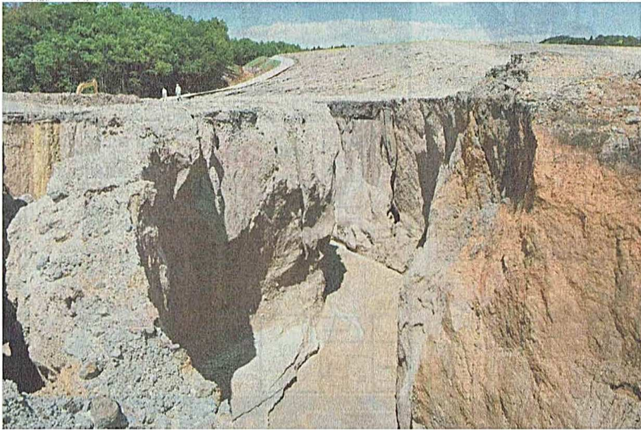
大規模な浸食が確認されたメガソーラーの建設現場 =11日、霧島市霧島永水
